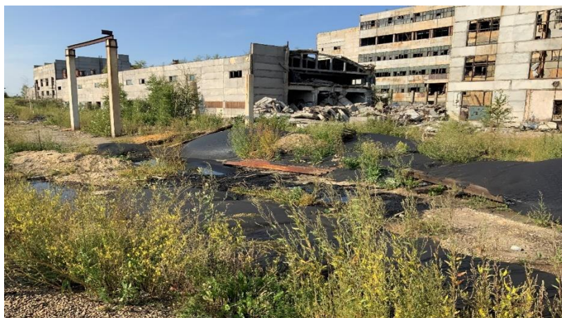
Рисунок 14. Состояние объекта ООО «Усольехимпром» возле цеха 62
