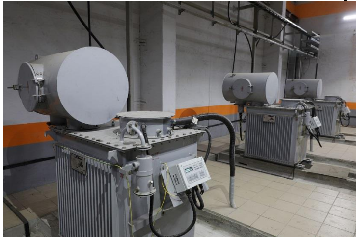
Рисунок 26. Электрофильтр Западно-Сибирской ТЭЦ – филиала АО "ЕВРАЗ ЗСМК"
